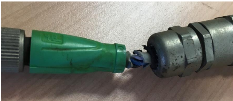
Afbeelding 3. Beschadiging kabel axiaal meting
