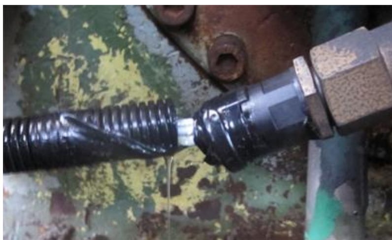
Figuur 1. Voorbeeld van een olie lekkage in een sensor als gevolg van onvoldoende oliebarrières.
